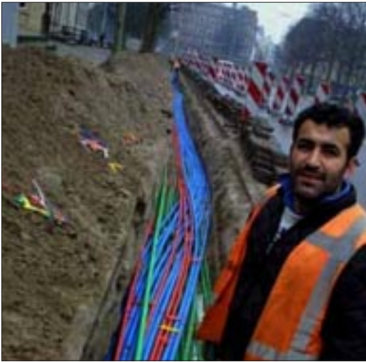
Foto 3. De aanleg van glasvezelkabels voor telecommunicatie, ergens in Den Haag (bron: NRC Handelsblad, Leo van Velzen).
